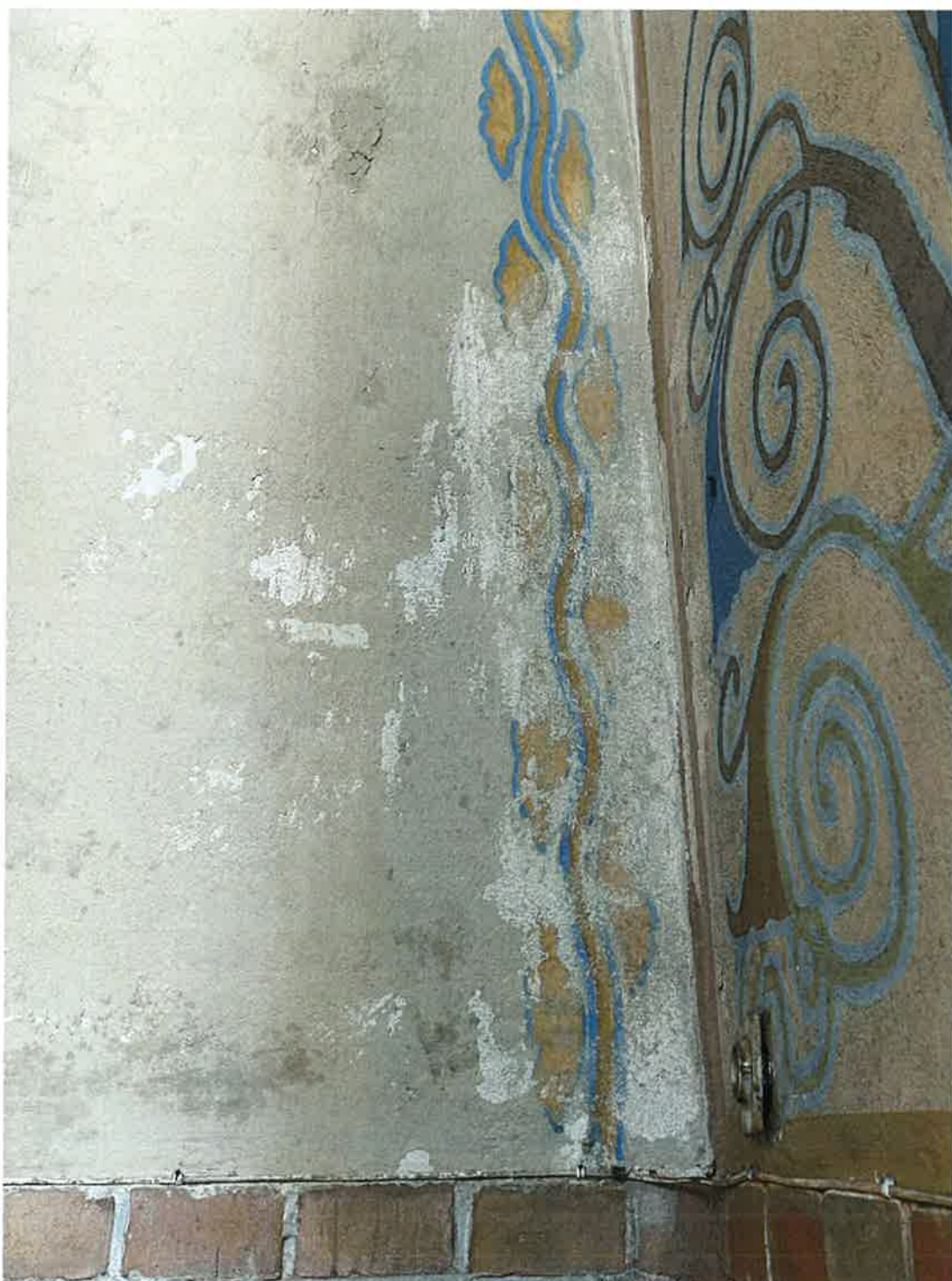
Fot. 9. Stan zachowania. Ściana wschodnia. Widoczne liczne ubytki warstwy malarskiej
